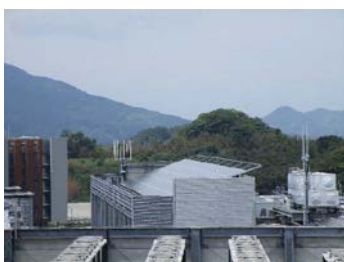
建物屋上の太陽光パネル
