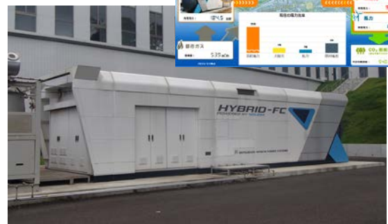
300kW 燃料電池発電設備
