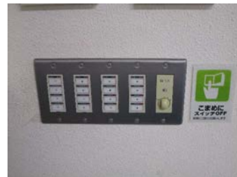
事務室照明スイッチ付近に掲示
