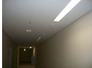
【間引き点灯の様子 病院外来棟 5 階】
